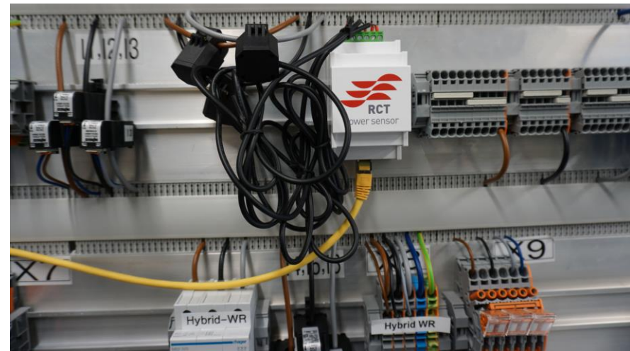
Bild 57 Der Power Sensor von RCT Power erfasst über sogenannte Klappstromwandler die Ströme auf den 3 Außenleitern am Netzanschlusspunkt (Bild: KIT).
