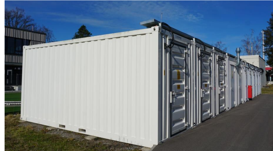
Bild 55 Container auf dem Campus des Karlsruher Instituts für Technologie (KIT), in denen sich die 6 Prüfstände befinden (Bild: KIT).
