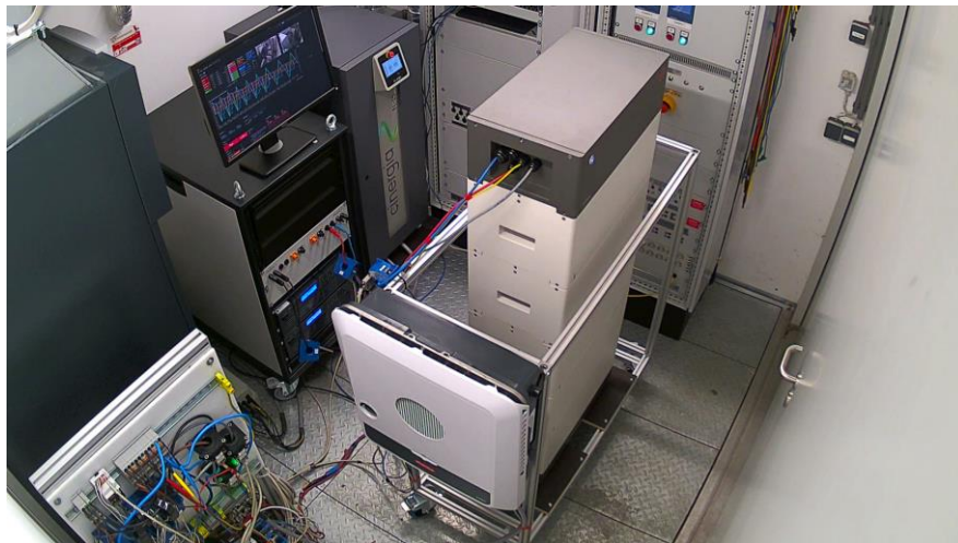
Bild 18 Prüfstand des Austrian Institute of Technology (AIT) in Wien, auf dem der Hybridwechselrichter FRONIUS Symo GEN24 12.0 Plus SC in Kombination mit der BYD Battery-Box Premium HVS 12.8 vermessend wurde. Insgesamt 8 Speichersysteme, die in dieser Studie verglichen werden, hat das AIT getestet (Bild: AIT).
