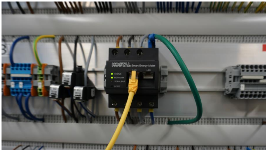
Bild 58 Der KOSTAL Smart Energy Meter überträgt die Leistungsmesswerte über eine RS485-Schnittstelle via Modbus-Protokoll an den Wechselrichter (Bild: KIT).
